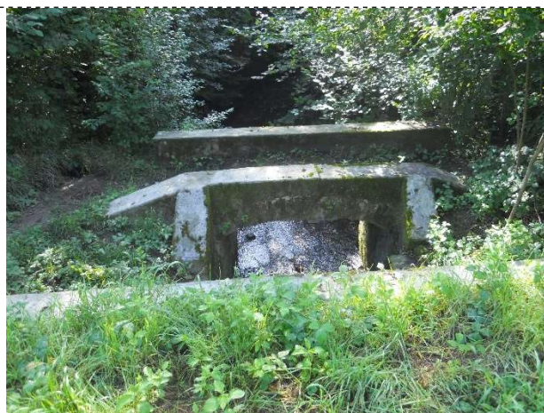
Figura 27 – Opera di presa in corrispondenza di canale irriguo (Foto: E. Artusio)
